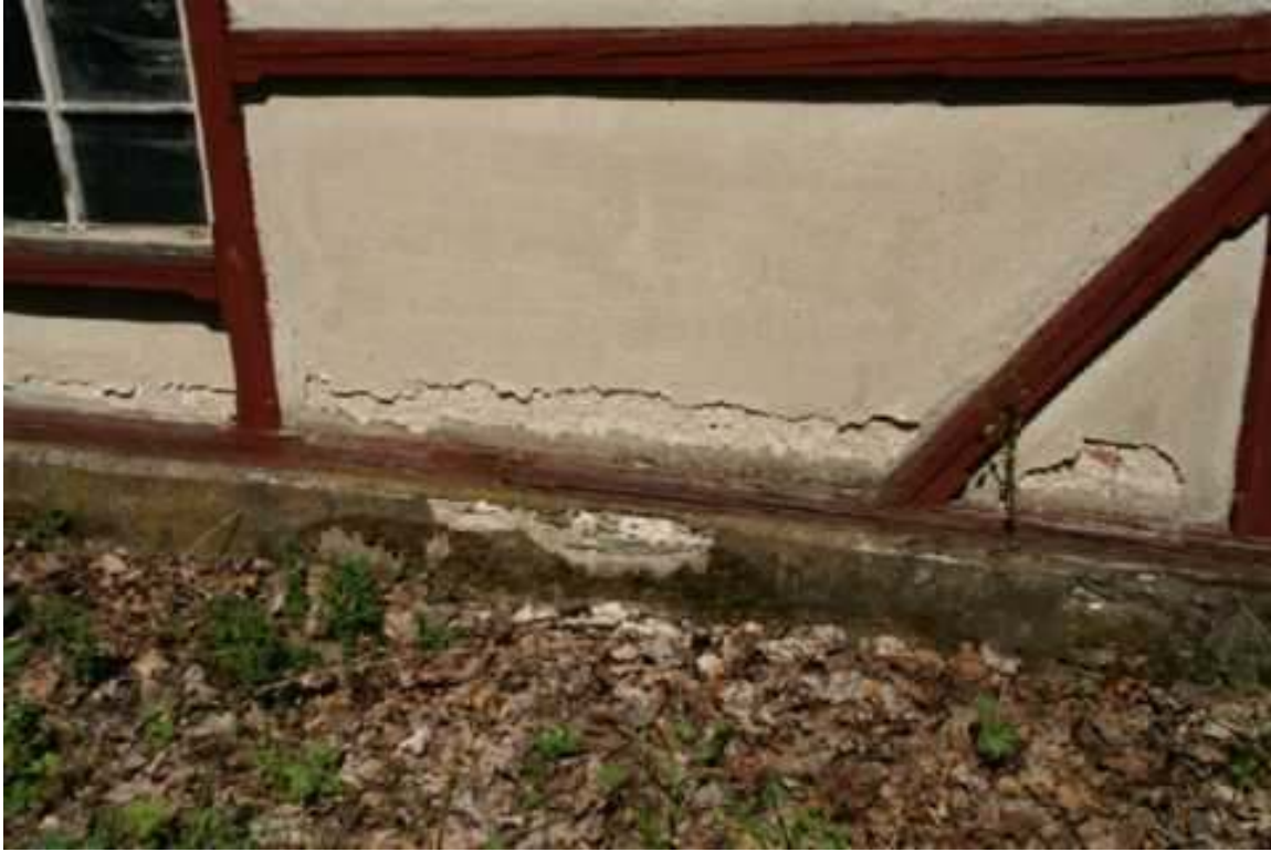
abgeblätterter Kalkfarbenanstrich / Putzflächen
