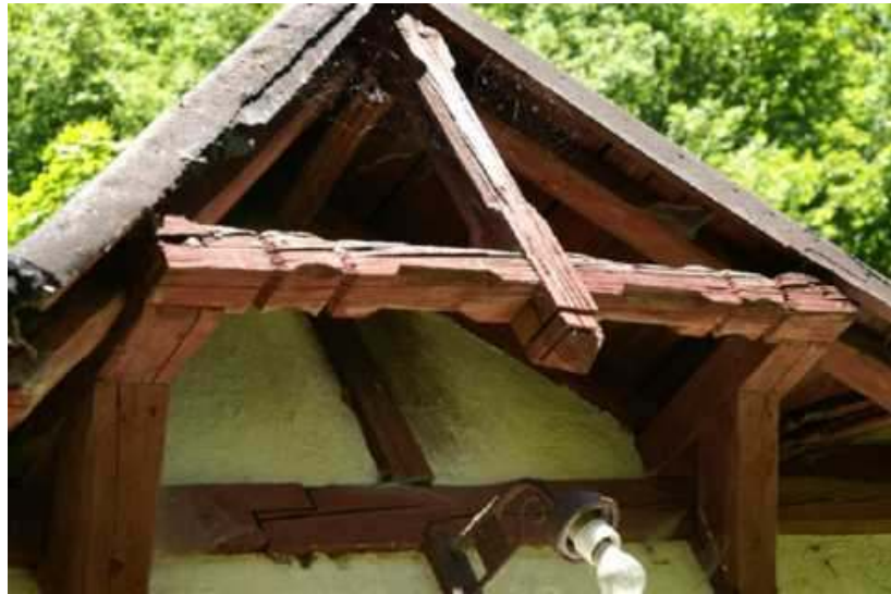
tiefe Risse ( Tischlerarbeit)
