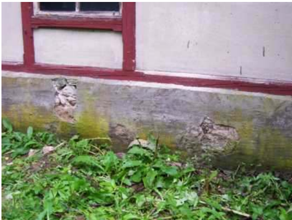
abgewitterte Farbe, Moosbefall, Putzschäden ( Maurerarbeiten)
