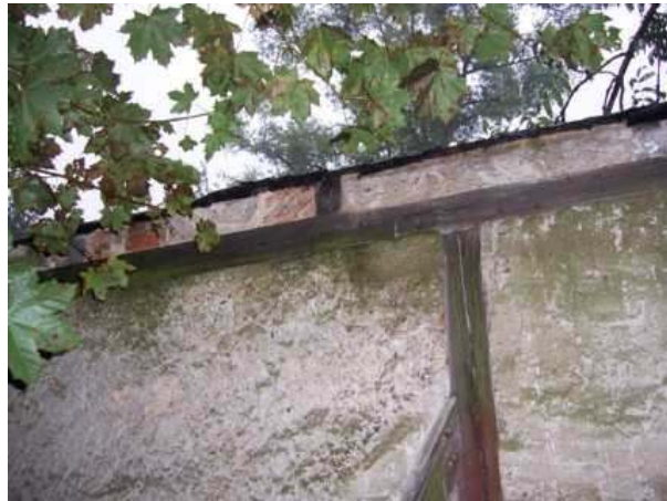
Moosbefall, Putzschäden, kreadende Altbeschichtung
