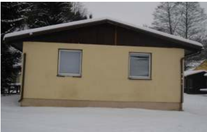
Schmutz an Fassade und Sockel, Verwitterung der Lasur
