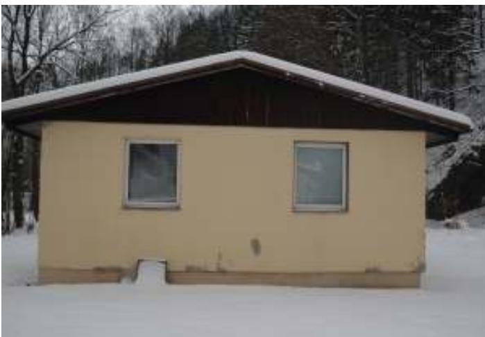
Spachtelflächen, Verwitterung der Lasur
