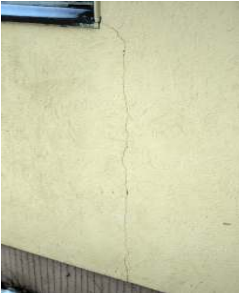
Risse durch Erschütterung
