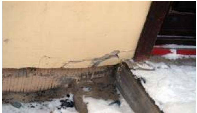
Putzschäden und Risse
